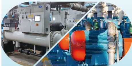
空調冷卻水/冰水泵/冰水主機 節能控制
